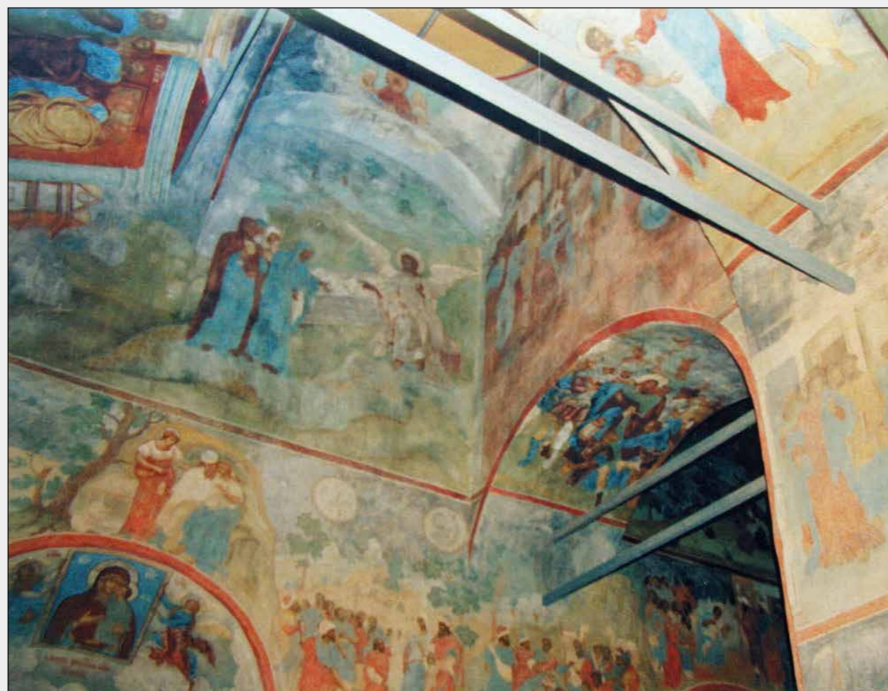
Церковь Владимирской иконы Божьей Матери. Село Кулиги Нерехтского района. Фрагмент интерьера до реставрации (вверху) и после реставрации (внизу)
